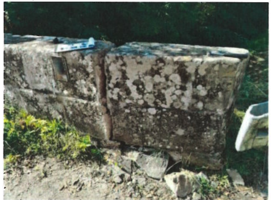
17H-BRÜSTUNG HI LI SCHADEN (5)
