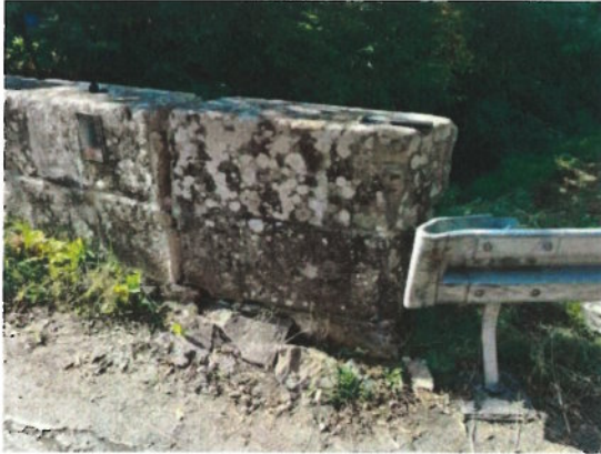
17H-BRÜSTUNG HI LI SCHADEN (1)
