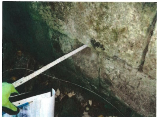
17H-MÖRTEL AUSGEWASCHEN FLW VO LI
